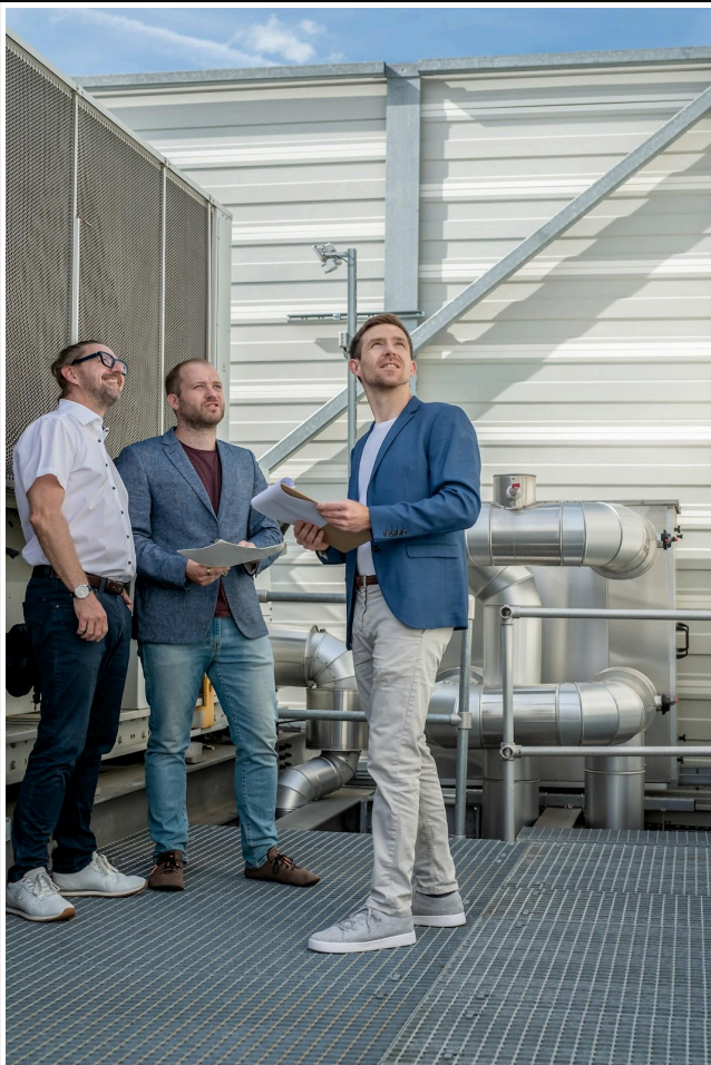
Steffen David (IPB), Ludwig Brand (BA) und Michael Adam (BA) auf dem Dach des Rechenzentrums vor Kühltechnik
